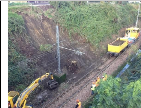
Foto – Frana Germignaga su ferrovia – 2014 – fonte varesenews
