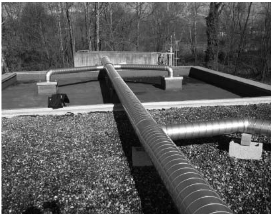
Tubazioni di aspirazione sulla copertura dei locali di disidratazione.
